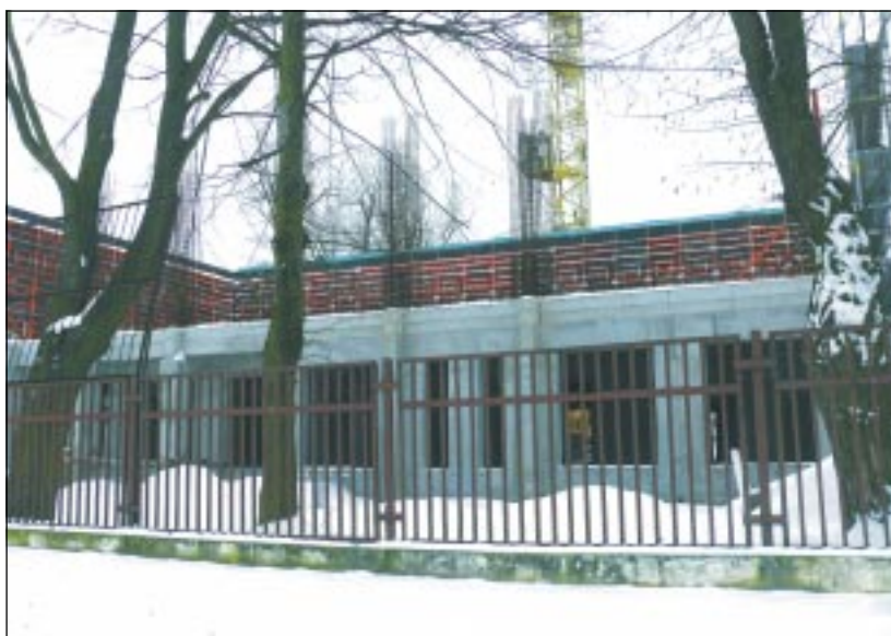
Ferie w zimowej szacie cieszą uczniów. Późna zima pozwoliła na znaczący postęp prac przy rozbudowie Szkoły Podstawowej nr 3 przy ul. Pomnikowej.
